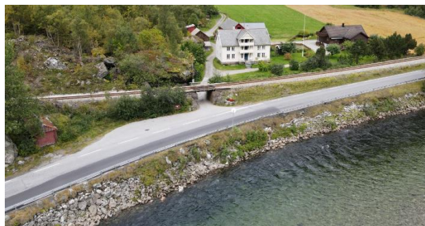
Figur 4-13 Påvist erosjonsskade og dårlig bæreevne i veifyllingen ved Flatmark.
