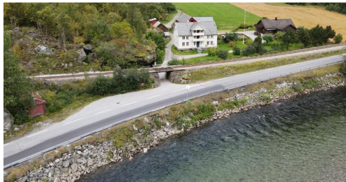
Figur 3-12 Påvist erosjonsskade og dårlig bæreevne i veifyllingen ved Flatmark.
