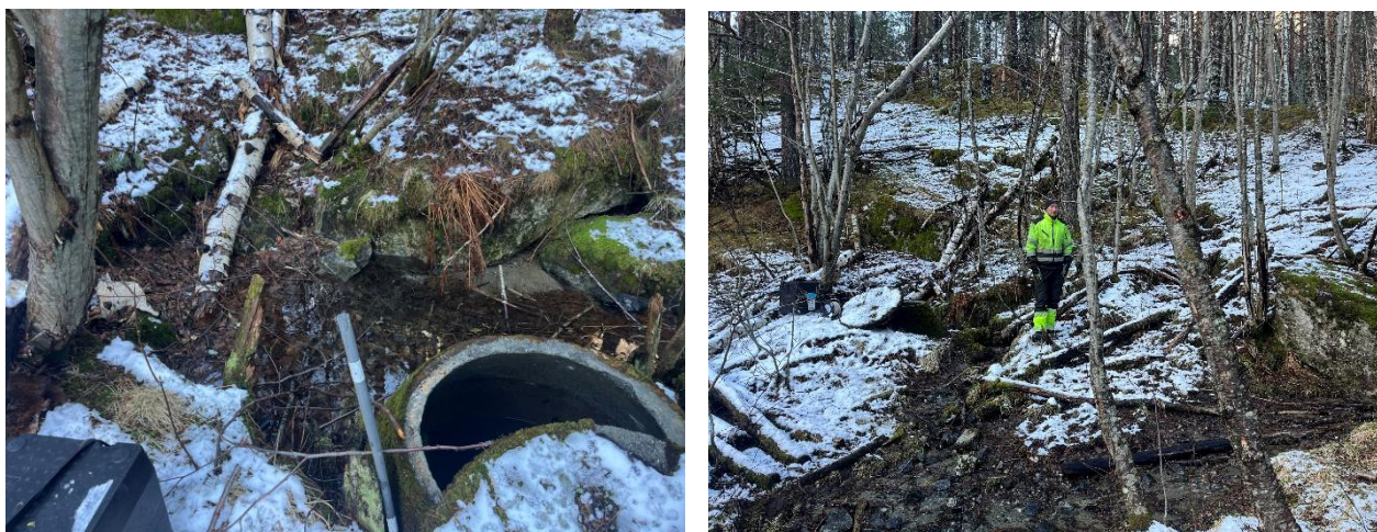
Figur 4-6 Til venstre - bilde av grunnvann som slår ut i bakkant av oppsamlingskum. Til høyre - bilde som viser plassering av oppkomme og oppsamlingskum
